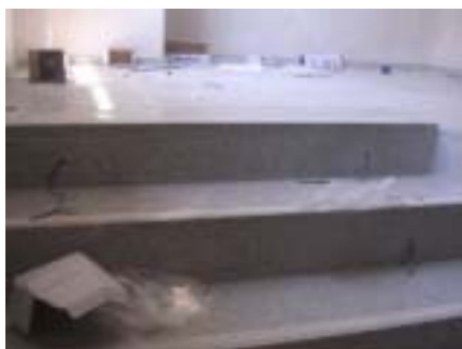
Estado habitual de las escaleras de emergencia de la C/ E. Ferrer
